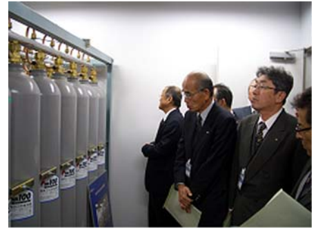
窒素ガスでの消火設備
